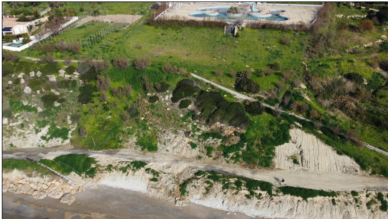
Figura 10 - Area in dissesto (vista da sud).
